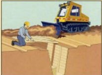
Оборудование перекрытой ямы
